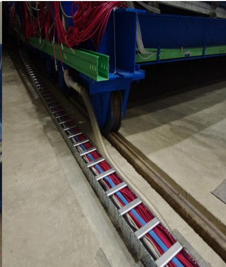
图 5.8 探测器尾气排放管
